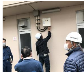
200V 差込で体育館内通電
